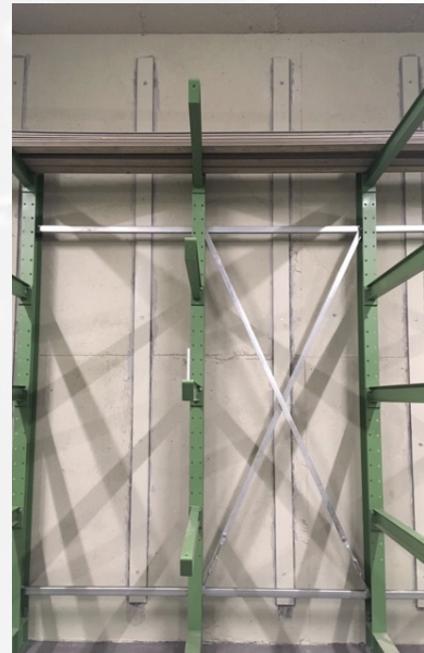
Montage hinter Hochregal
