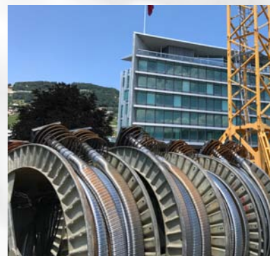
Vorspannkabel auf Bobinen
