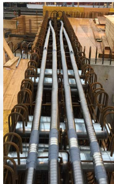
Vorspannkabel im Unterzug
