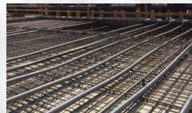
Flachdecke Parking: Kabel 1306
