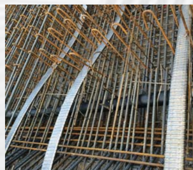
Flachkabel in der Armierung
