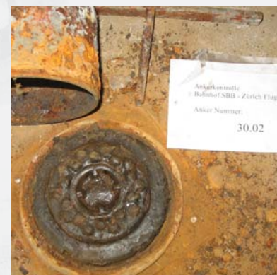
Beispiel: Anker vor Kontrolle
