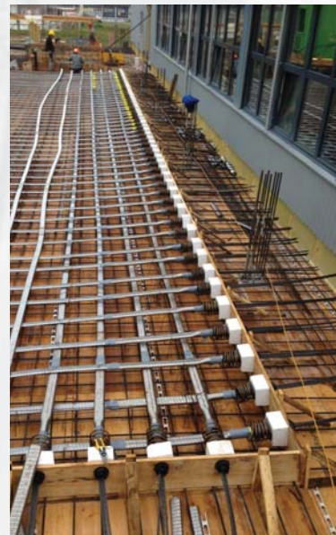
Positionierte Kabel, mobile Köpfe in Sagex
