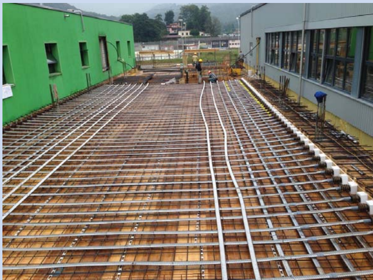
Positionierte Kabel, mobile Köpfe in Sagex
