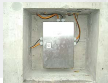
Zentraler Messkasten in der Wand
