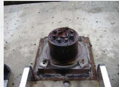
Tête d'ancrage, Gripons Nord, Saint-Ursanne
