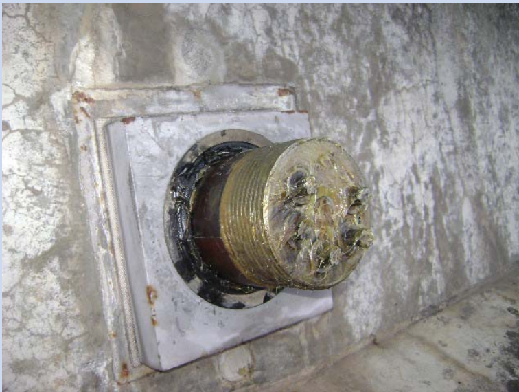
Tête d'ancrage, Montchoisi, Develier
