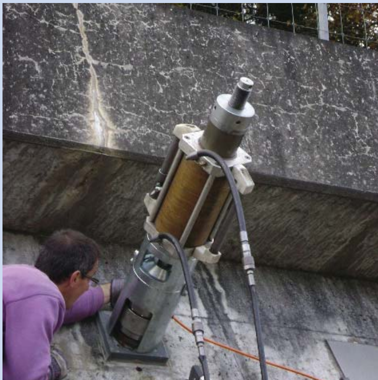
L'Avenal, Develier, Auswechseln der Kraftmessdose
