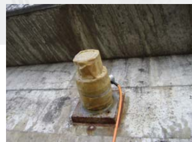
L'Avenal, Develier, neue Kraftmessdose
