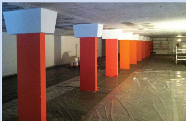
StüKo mit Brandschutzverkleidung
