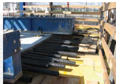
Hüllrohre für die Kragarmvorspannung
