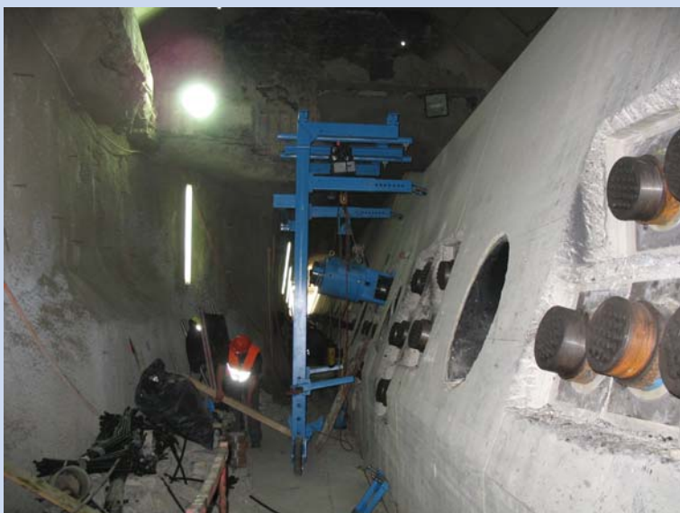
Umgebaute 500 to Spannpressen
