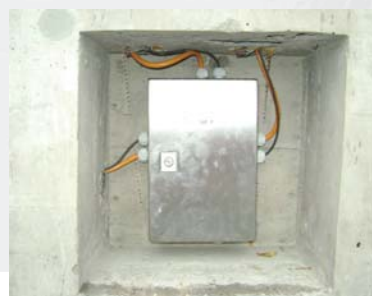
Coffret de mesures dans un mur
