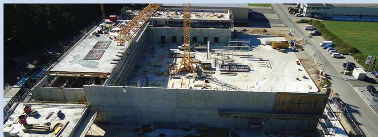
Ansicht auf das vorgespannte Blocklager und die Kommissionierung
